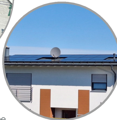
▶ Blechdach mit Stehfalz, Einfamilienhaus 11 KWP
